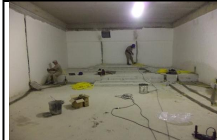
Instalação Elétrica Templos 4 e 5
